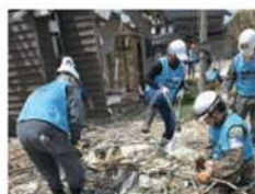
能登町の津波被災地域にて被災財を片付けるボランティア
